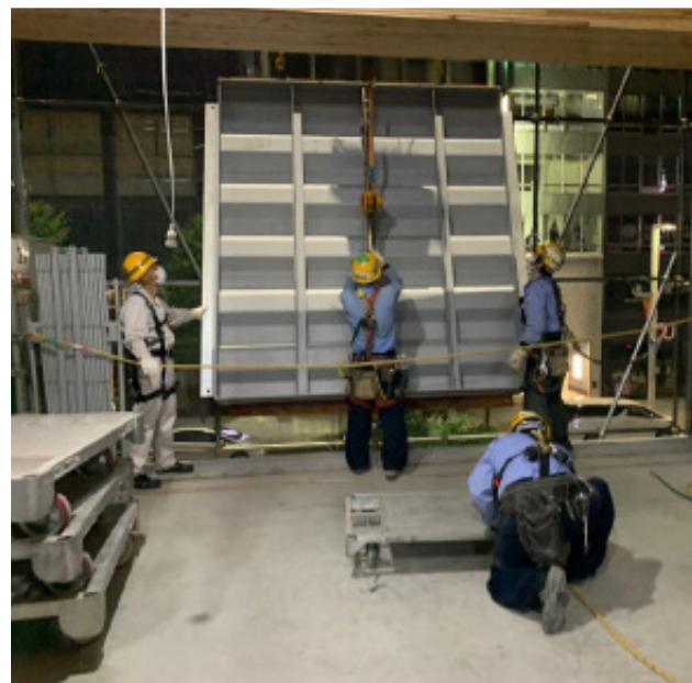
制震壁取り付け状況
