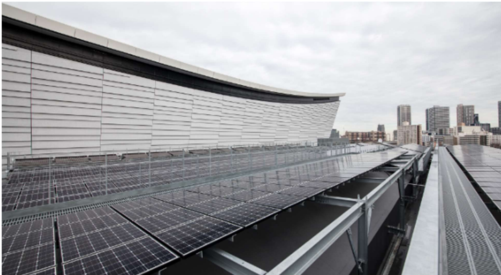
太陽光パネル
